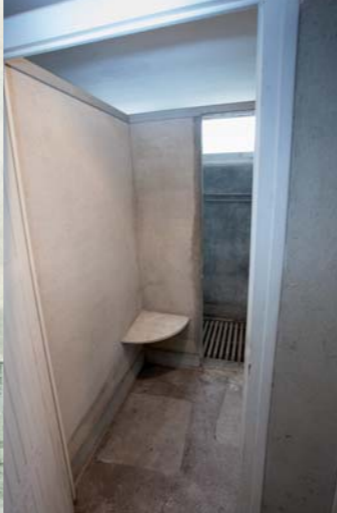
Douche du groupe scolaire de Tresson.
