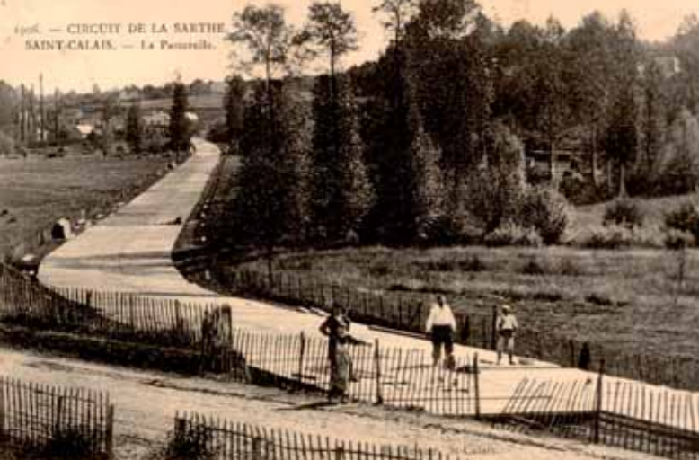
Construction de la route planchéiée à Saint-Calais. Coll. Arch. dép. Sarthe, 2FI08990
